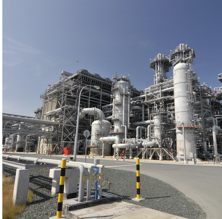
Завод по производству СПГ «Сахалин-2»
