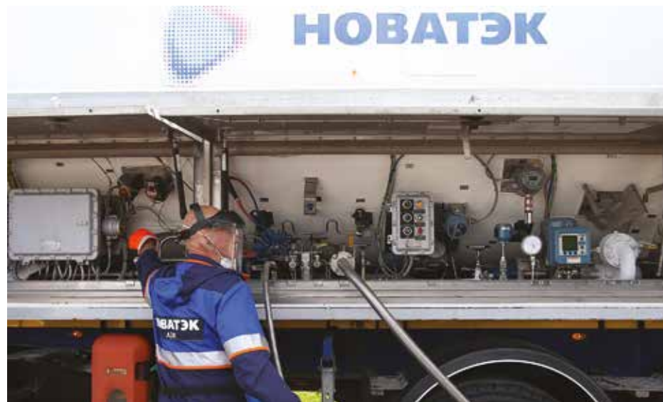
Установки по производству малотоннажного СПГ Источник: sdelanounas.ru
