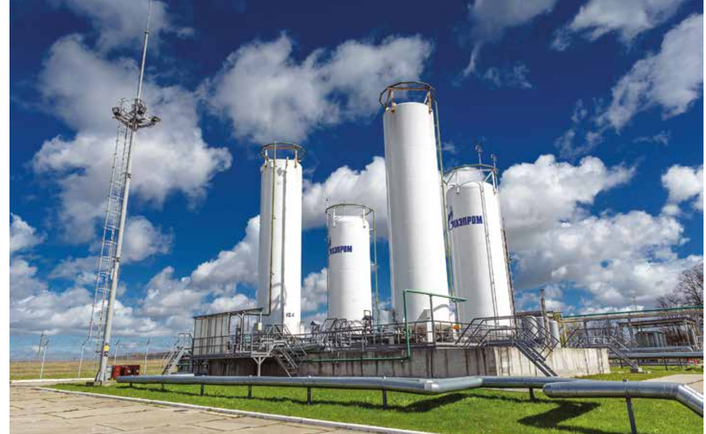
Завод малотоннажного СПГ
